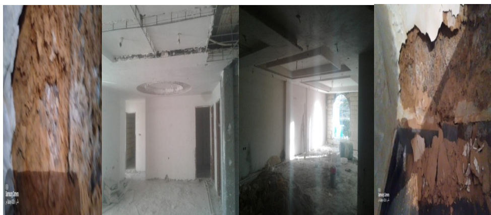
(طلبه شدن گچ دیوار) (استفاده از چسب تقویتی گچ برای سقف کناف و دیوار) (خوردگی و تبخیر آب گچ و طبله شدن)
